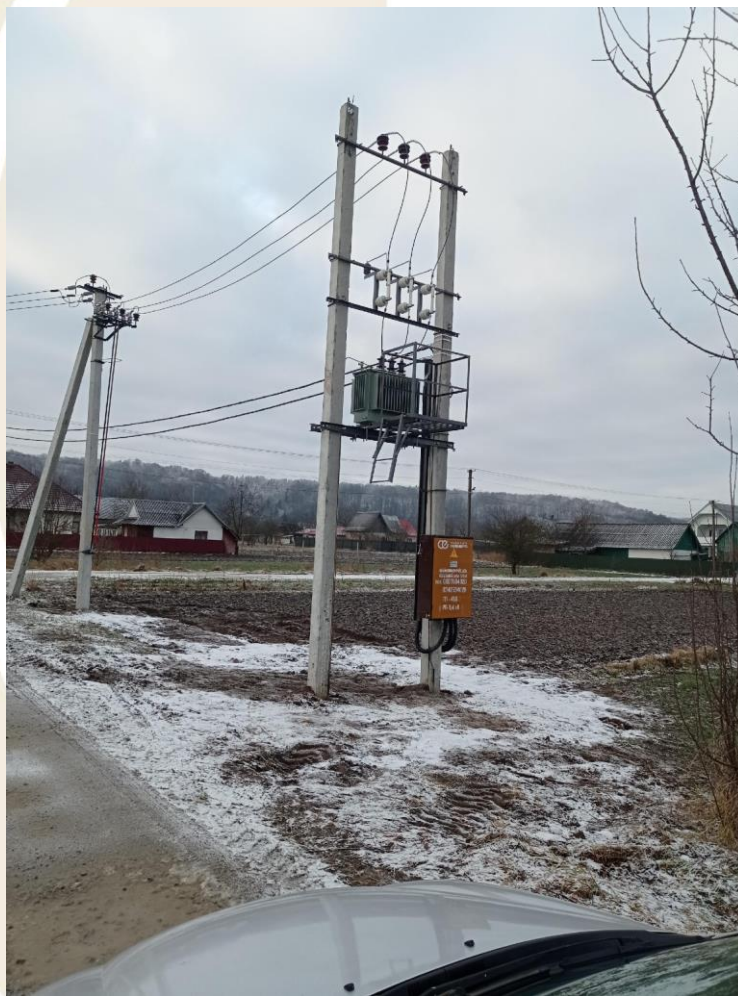
Силовий трансформатор по вул. Шевченка
